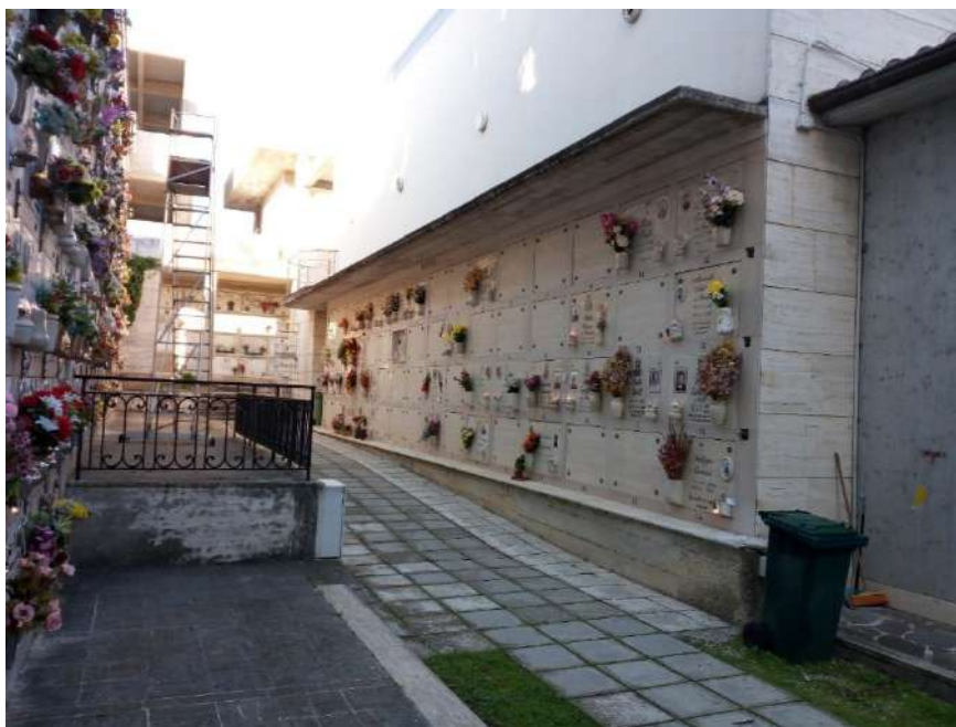
Figura 1 Vista della parete sud del lotto n. 20 e del viale di servizio
